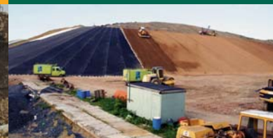
Ein unsachgemäßer Umgang mit Abfall kann Grundwasser verschmutzen.
